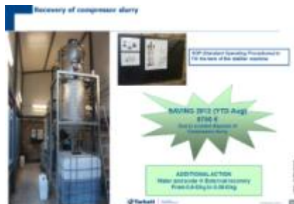
Separazione dell'acqua di Condensa dei compressori dagli oli
