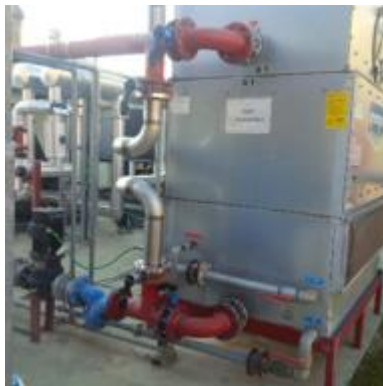
Ciclo chiuso di raffreddamento per l'impianto di trigenerazione
