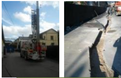
IMPIANTO DI GEOTERMIA
