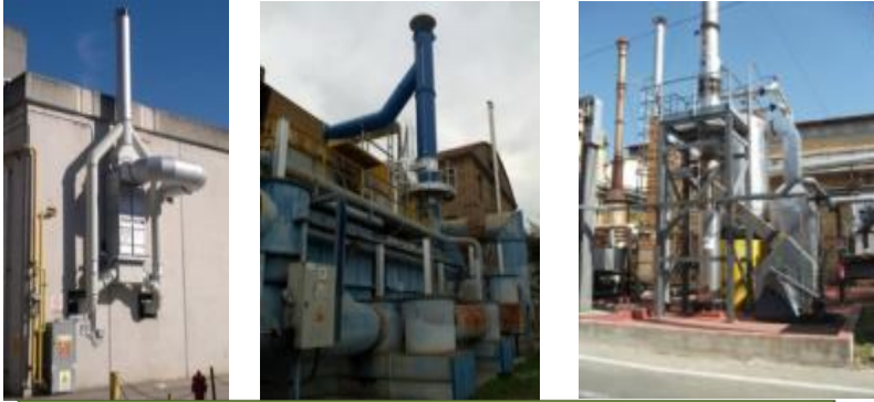
SCAMBIATORI DI CALORE CALDAIE E POST COMBUSTORI
