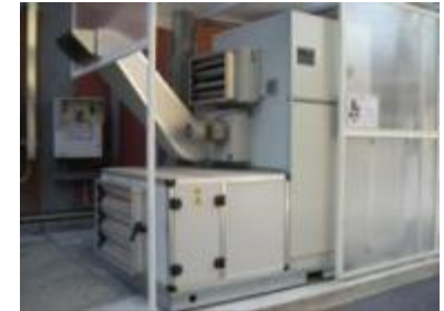
ESSICCATORE D'ARIA PER STAGIONATURA LINOLEUM
