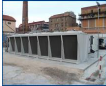
Ciclo chiuso di raffreddamento reparto ossidazione
