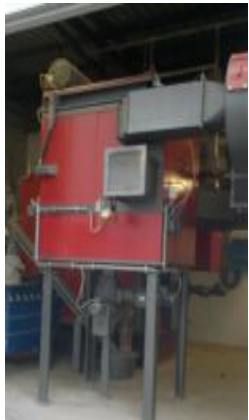
CALDAIA A BIOMASSA PER PRODUZIONE DI ENERGIA TERMICA DA FONTI RINNOVABILI
